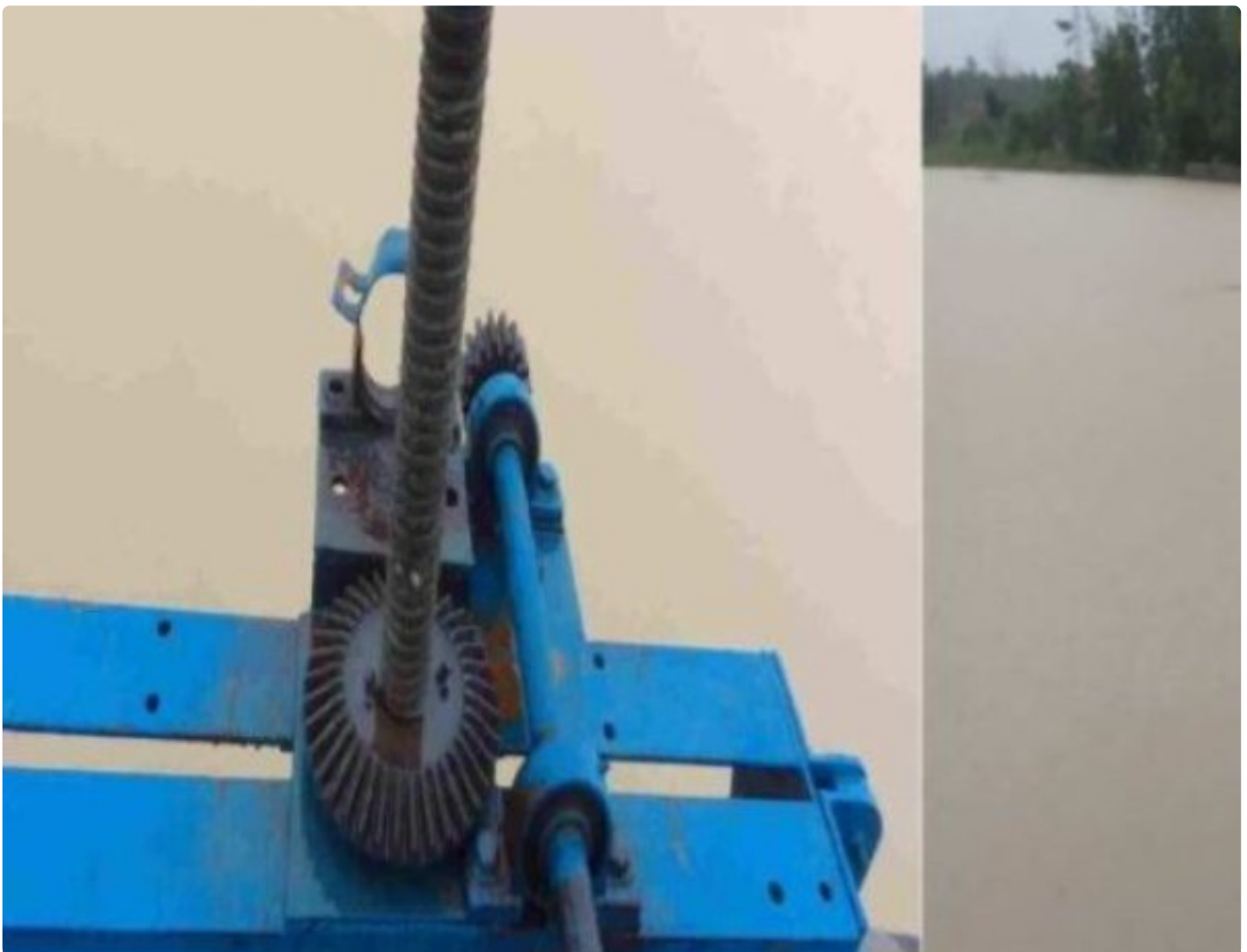
Pintu air Albaret Simpang Mesuji
